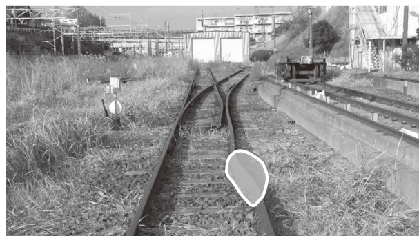
(b) レールのゆがみ
