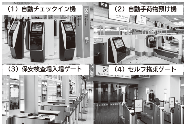
写真1 成田国際空港に設置された4つのタッチポイント
