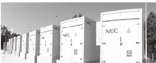
写真 系統用蓄電システム外観
