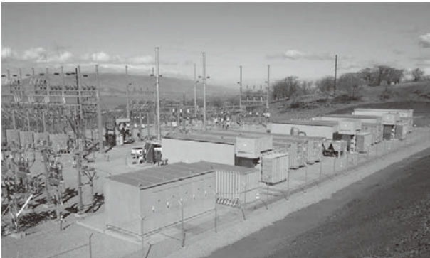
写真2 風力発電の出力安定化用 11MW/4.4MWh GSS (米国ハワイ州)
