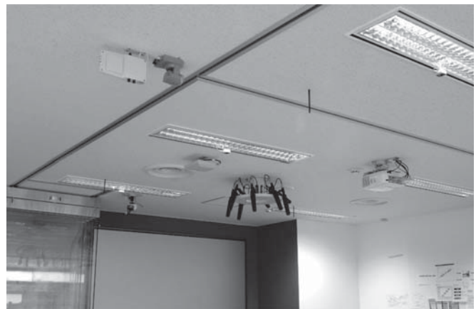
写真2 壁や天井には最新設備が埋め込まれている
