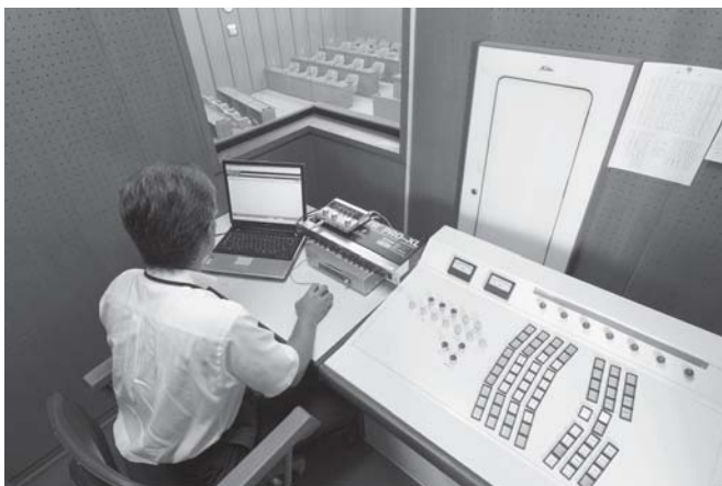
写真2 ミキサールーム
