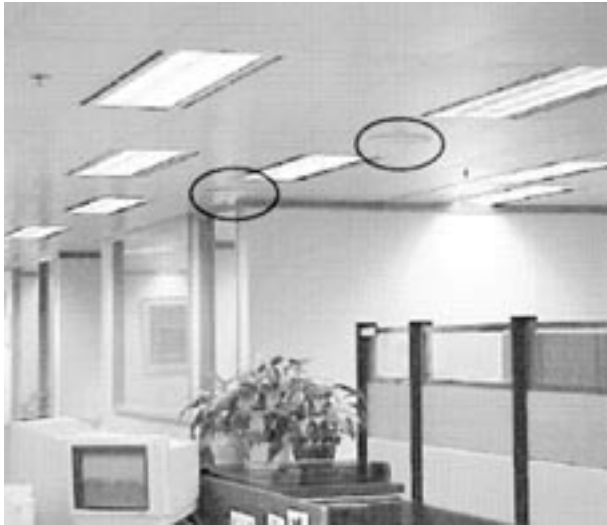
図6 屋内アンテナ設置例
