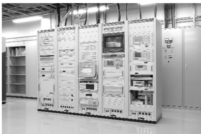
写真3 STL装置, OFDM変調器などを収めたラックの外観 Photo 3 STL, OFDM modulator and related equipment.
