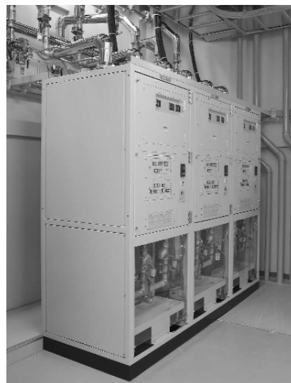
写真4 水冷制御盤 Photo 4 Cooling control rack.
