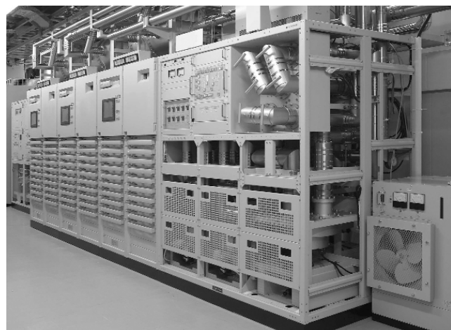
写真2 10kW デジタル送信機 Photo 2 10kW digital transmitter.
