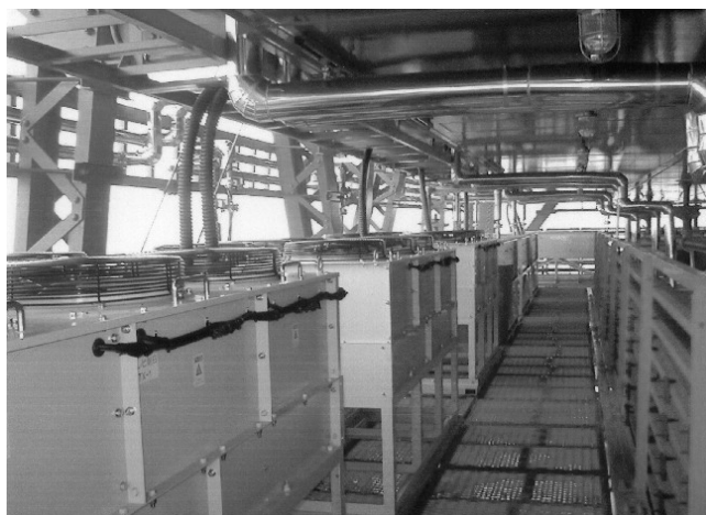
写真3 熱交換器 Photo 3 Heat exchanger.
