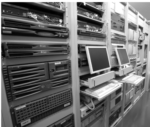
写真 報道支援システムラック外観
