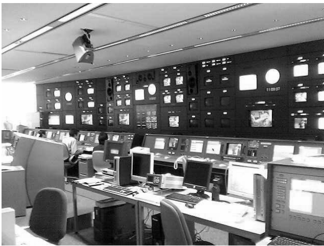
写真 スーパーマスター室 Photo Super-Master (Control room)
