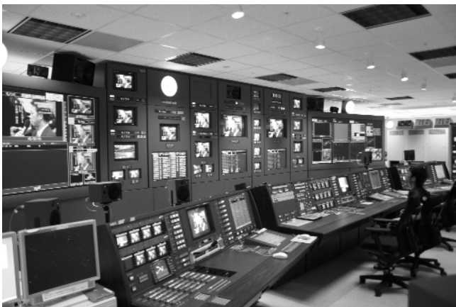
写真 監視モニターと監視卓の外観
