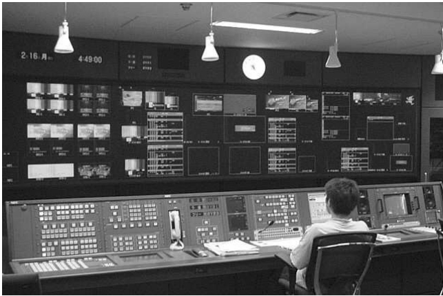
写真 東海テレビ放送(株) 殿 モニター設備
