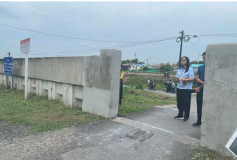
工業団地での洪水対策(止水板設置箇所と排水ポンプ)
