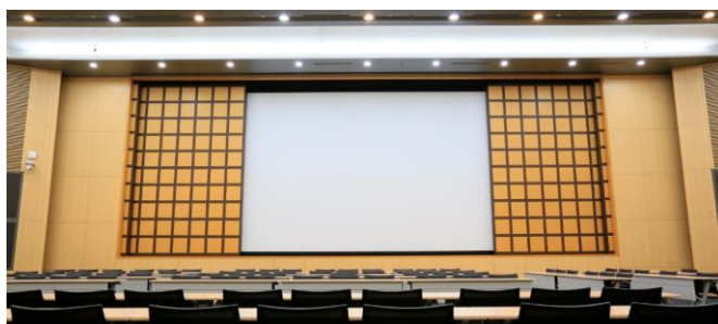
常設された大型スクリーン。電動で壁が開閉する。
