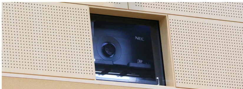
映写室に設置されたNP-PH1202HLJD。
