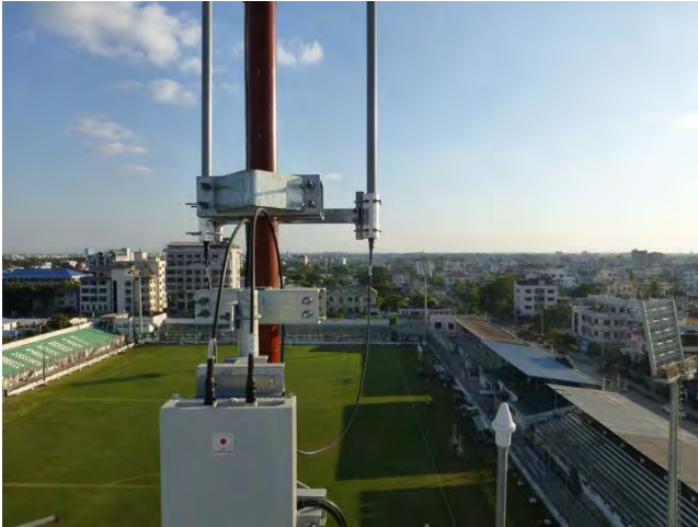
LTE 基地局 設置イメージ (マンダレーのサッカー場)
