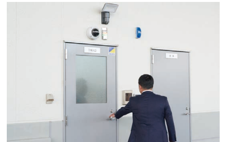
工場入口に設置された顔認証システム
