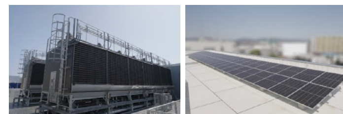
屋上フリークーリング(二期棟)
