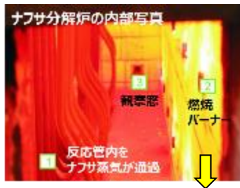
約850℃でナフサ熱分解している炉の熱源をアンモニアに転換
