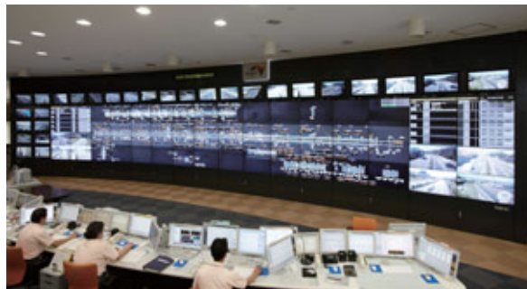
新東名高速道路の道路管制センター
