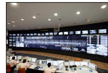
新東名高速道路 道路管制センターの大型表示装置
