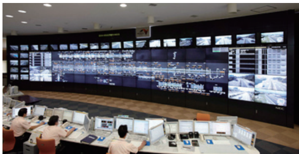
道路管制センターの大型表示装置
