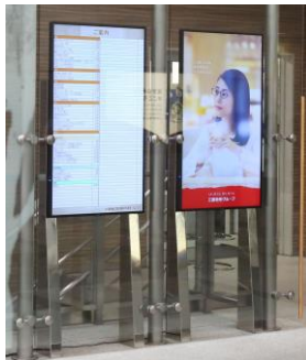
デジタルサイネージ設置後の1階エントランス
