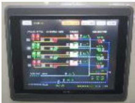
空調関連設備の制御盤
